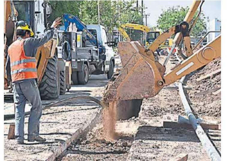
RELEVAMIENTO. A la fecha se han visitado 130 municipios de la provincia, detectando diversas irregularidades en las obras de infraestructura desarrolladas en ellos.
