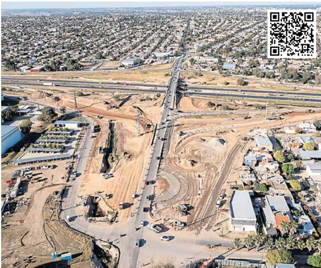
TRABAJOS. Vista aérea del avance de la obra que aliviará el acceso noreste de la ciudad de Córdoba.
