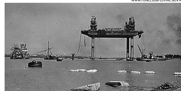
EMPLAZAMIENTO. Los tubos se colocaron con una Isla flotante que medía 38,6 metros de eslora. Tenía cuatro columnas de acero con cremalleras de 65 m de altura.
