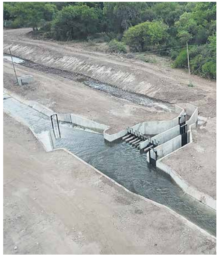
OBRA. Derivación "pico de pato" al sistema de riego Santa Ana desde el nuevo canal revestido de la margen izquierda del Dique Pichanas (año 2018).
