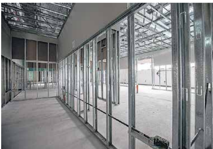
Obra rápida: los interiores se ejecutan bajo el sistema constructivo de Steel Framing, una obra seca, rápida y de bajo nivel de desperdicio.
