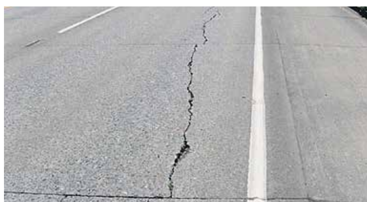
Son frecuentes en el asfalto de carreteras o rutas las fisuras longitudinales como este caso, que se califica como severa.
