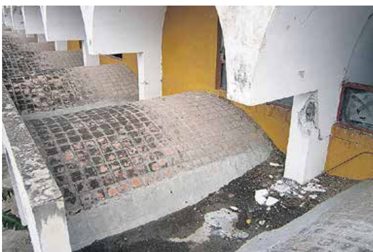
Fallas de columnas de pórticos por dilatación térmica.
