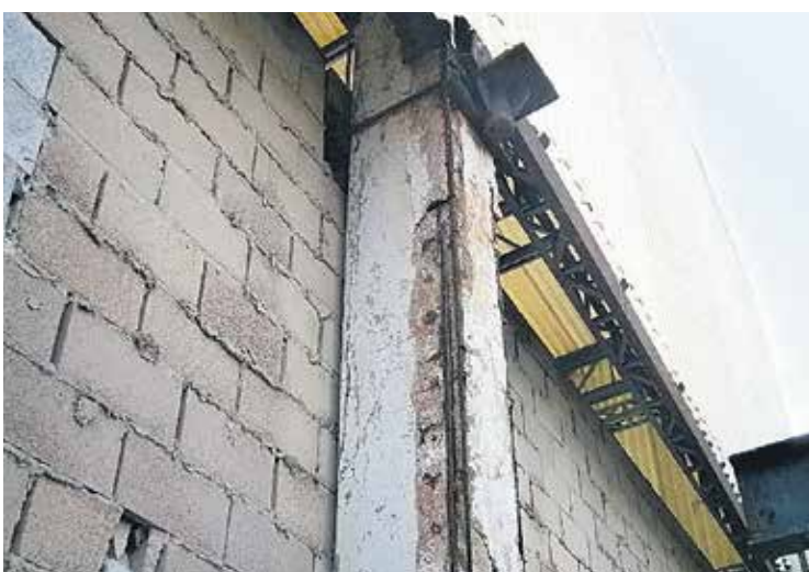
Corrosión de hierros de una columna de hormigón armado
