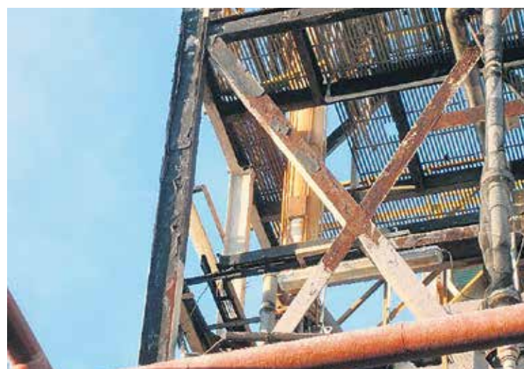
Corrosión de elementos de una torre metálica.
